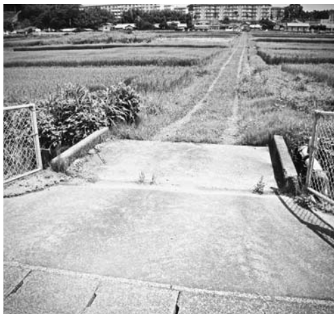
用水路の転落防止柵は万全か？
