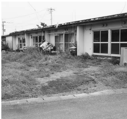
どうするの？老朽化した公営住宅
