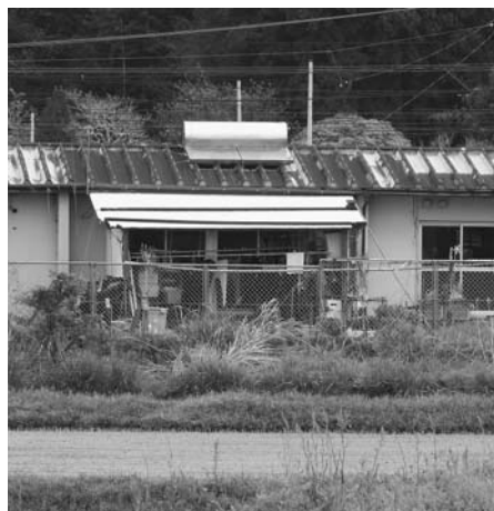
老朽化が進む成法寺住宅
