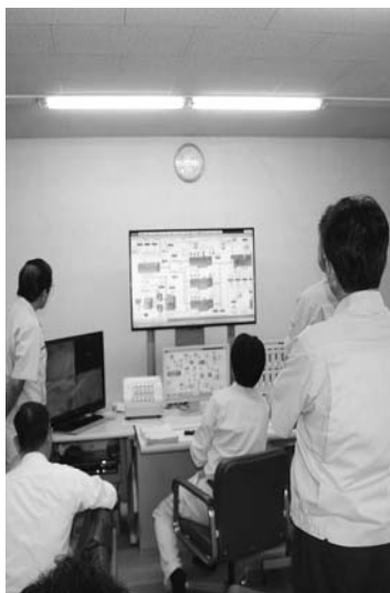
コントロールパネルを使った浄水場の説明
