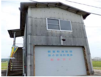
老朽化した消防機械倉庫
