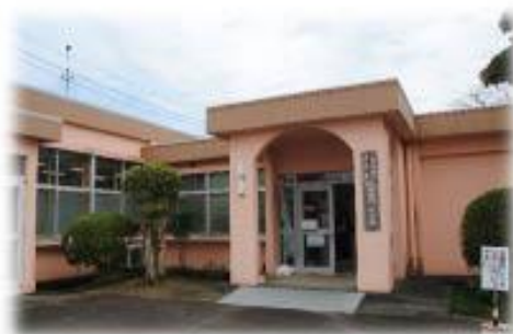
避難所にもなる施設、早急な雨漏り対策を
