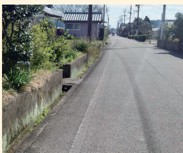
狭い通学路の危険な側溝
