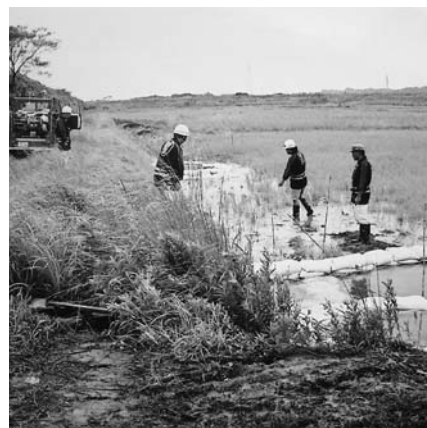
平成17年の堤防からの湧水
