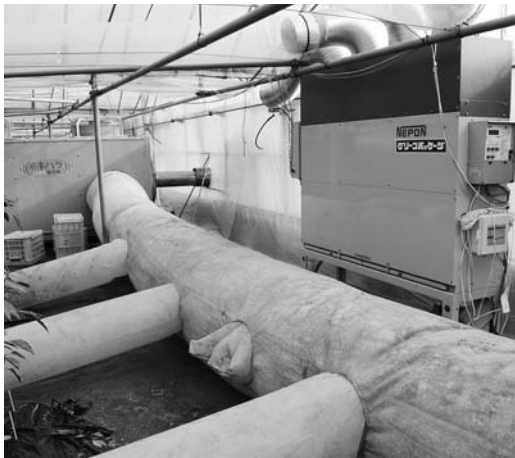
ハウスに設置されたヒートポンプ
