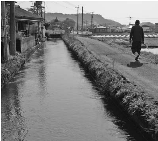
老朽化が進む金丸堰用水路
