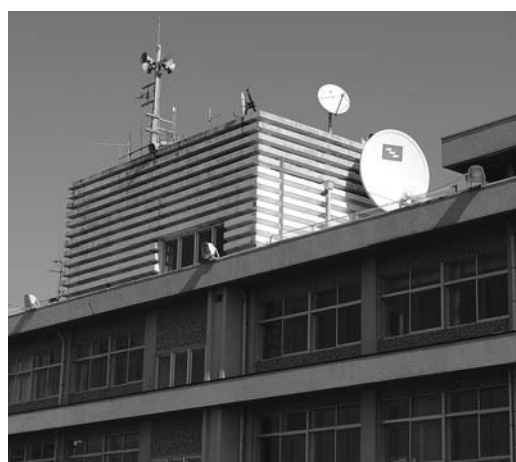
役場庁舎屋上に設置されている防災関連情報通信設備
