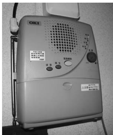
各戸に設置されている行政防災無線の端末機
